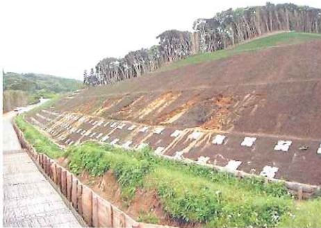
写真-7 中段部崩壊状況
