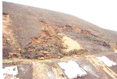
写真-8 中段部崩壊状況
