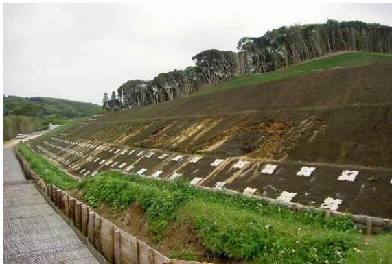
写真-6 盛土状況 2 段目が崩落
